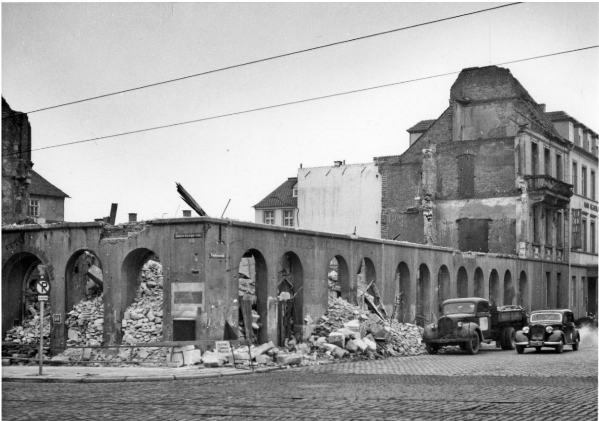
6 Abbruch der Ruine 1951; die drei rechten Fassadenachsen des früheren Palais werden in den Neubau übernommen. Dahinter entsteht ein durchgehender Stahlskelettbau bis zur Königsstraße.
